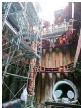
地下約10mの埋設配管
