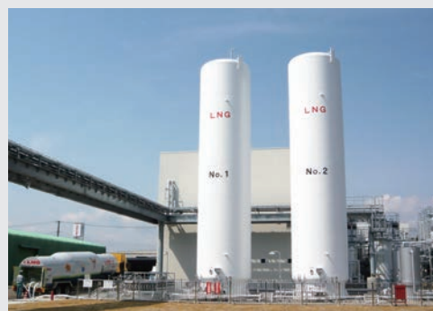
LNGサテライト設備
