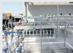
LNG加圧蒸発器
