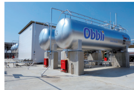
脱臭LPガスの貯蔵タンク
