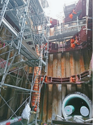
地下約10mの埋設配管
