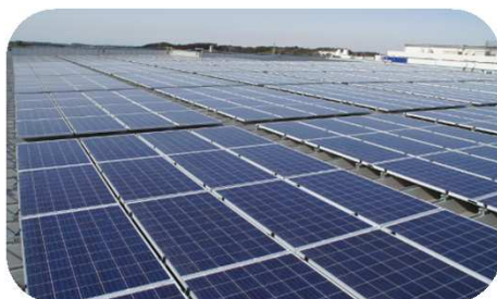
【当社太陽光発電設備】
